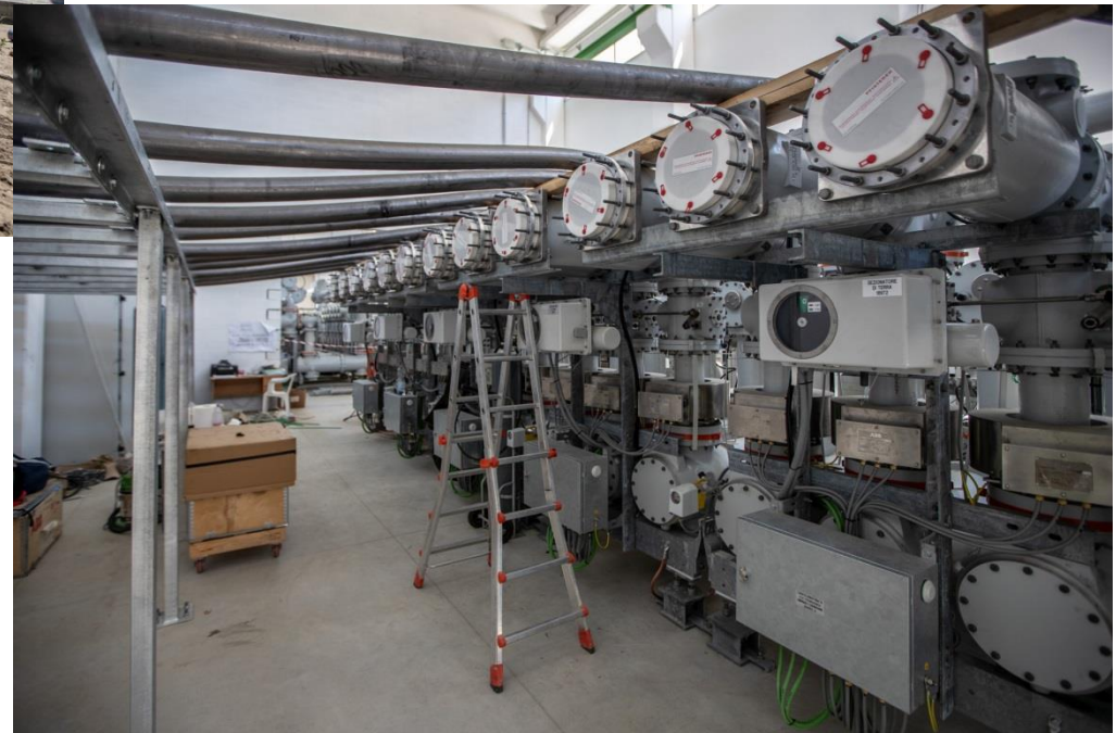
Sezionatori a gas inerte (Gas Insulating System)
